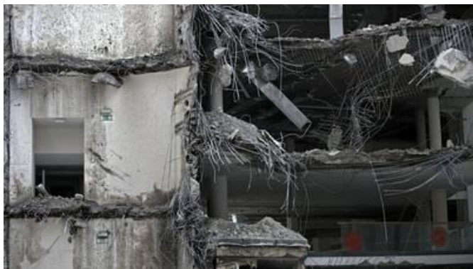
Baustelle SPD: Hier müsste mal wer ordentlich aufräumen.
